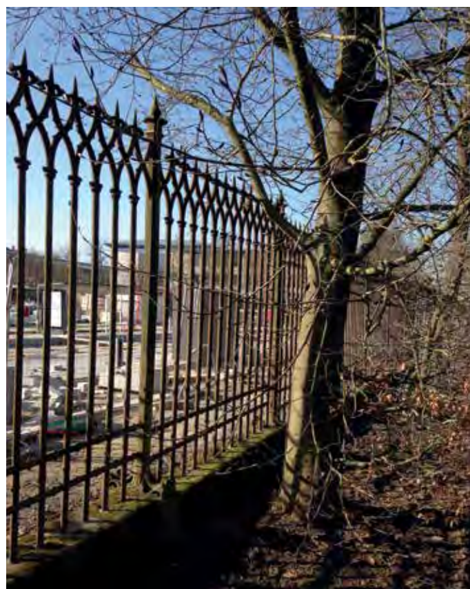
Abb. 1: Friedhofszaun vor der Restaurierung, Liebfrauenfriedhof in Luxemburg. Foto: © Rolph, 2017.
