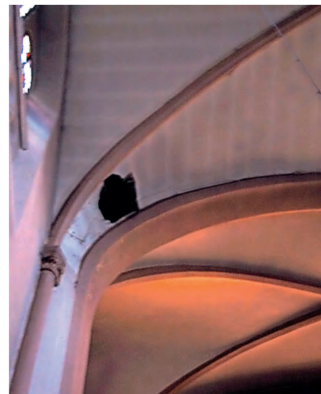
Bild 44: Deckendefekt im hinteren Teil des Mittelschiffes vor der Empore nach Gipsabfall am Tag der Oktave-Schlussprozession am 1. Mai 2005 [2005-05-01]
